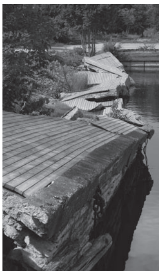
Linnainstallatsioonide festivali LIFT11 raames Siiri Vallneri ja Indrek Peili loodud Kai katab lagunenuid kai servast lahti murdunud betoonkamakad laudadega, et luua uued juhusliku kuju, asetuse ning suurusega terrassid kõikvõimalike suviste tegemiste tarvis.
