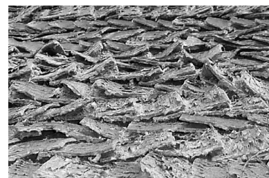
Kahjustunud laastukatuse (Fotod: M. Loit)
