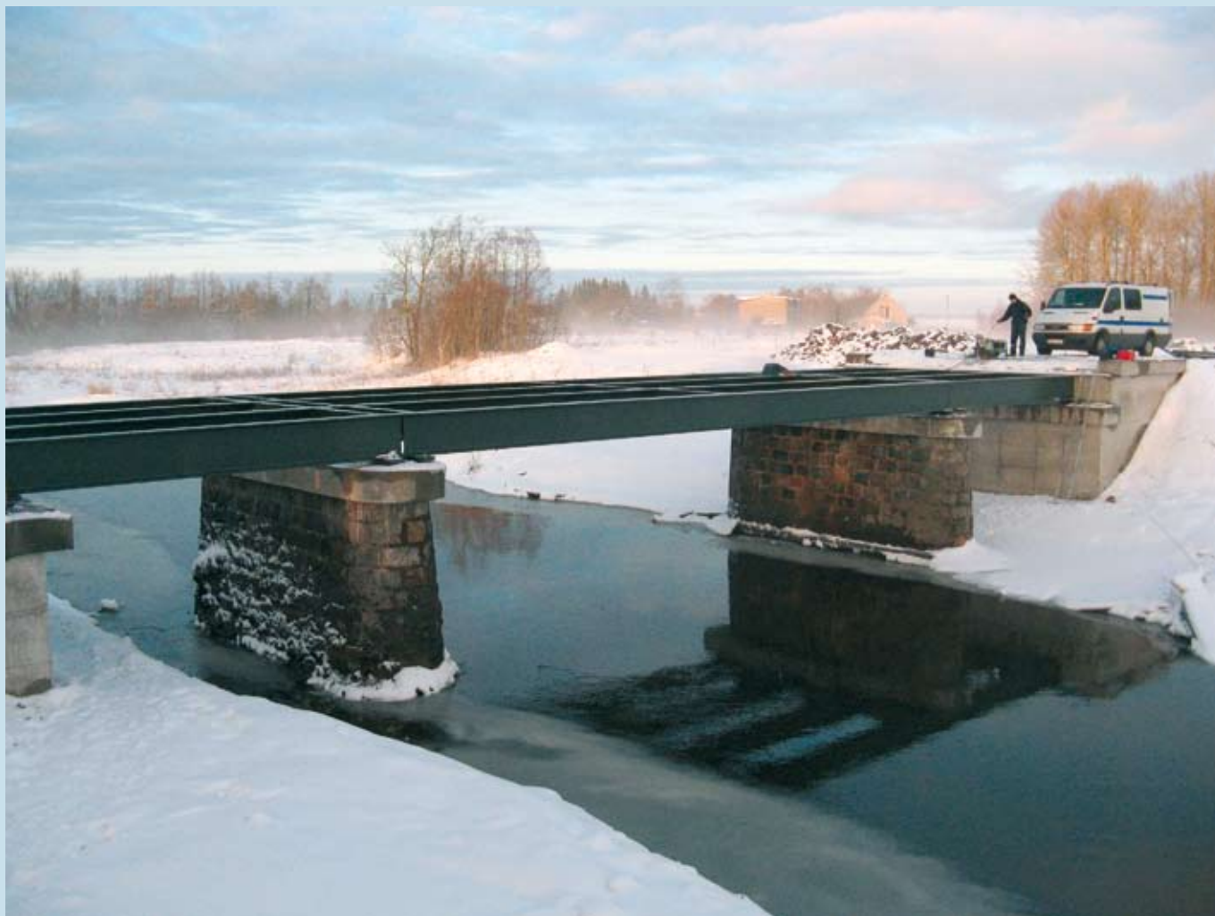
2009. aasta kevadel algas Läti silla ennistamine kolmeavaliseks. Rajati uued kaldasambad, avadesse pandi terasest lihttalad.
