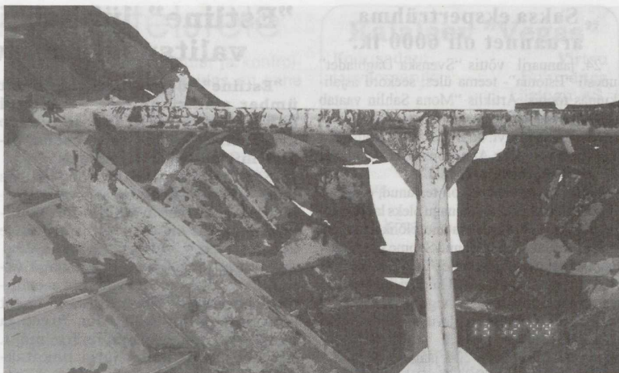
Visiiri põhjaosa on roosteplekiline.
