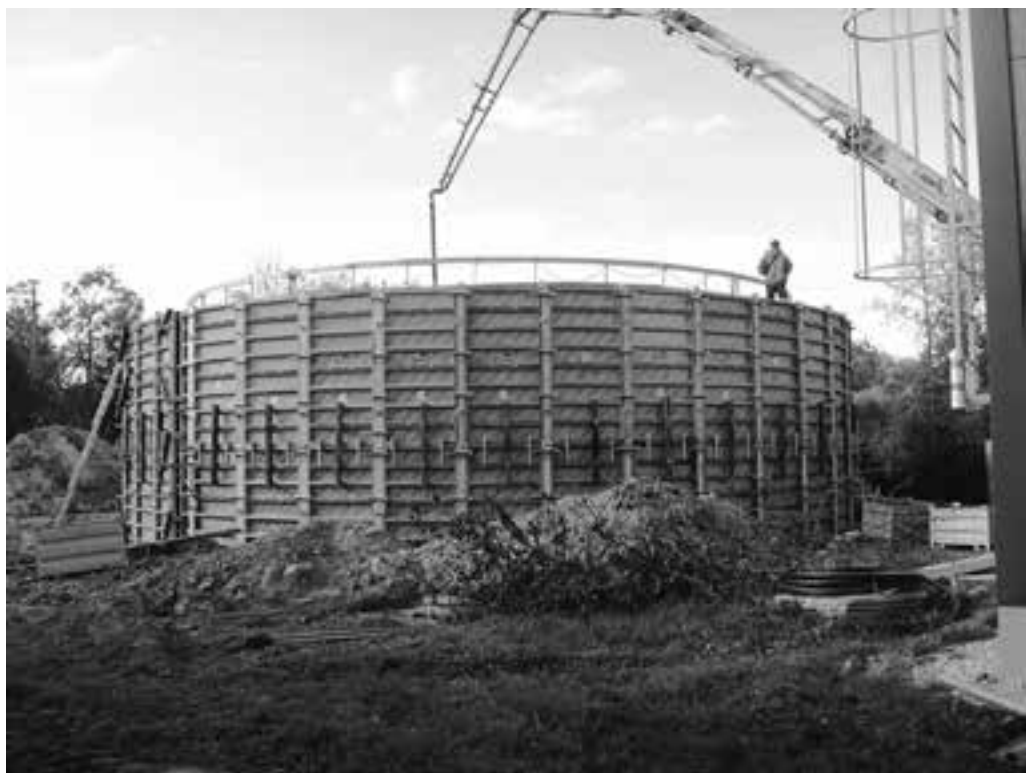
Põltsamaa linna reoveepuhasti ühtlustusmahuti (Foto: Ele Liivamägi).
