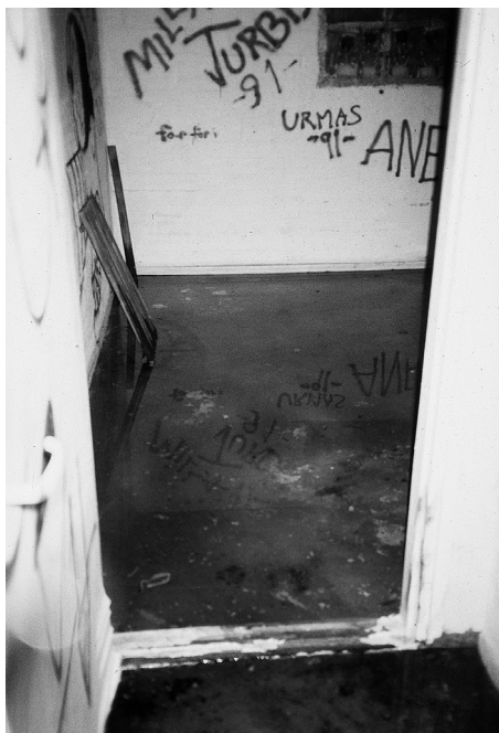
Foto: Päivi Loikkanen Vesi on valgunud ehitusdetailide liitekohtadest keldriruumidesse ja põrand on hakanud lainetama.
