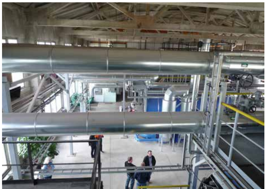
Sisemiselt uuendatud Võrusoo katlamaj ja . Reconstructed Võrusoo boiler house.
