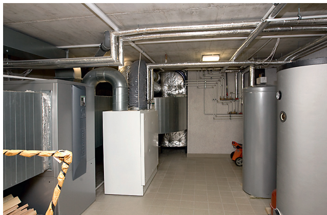
► Kõik kommunikatsioonid alates soojuspumbast ja lõpetades ventilatsiooniga on koondatud ruumikasse keldrisse.
