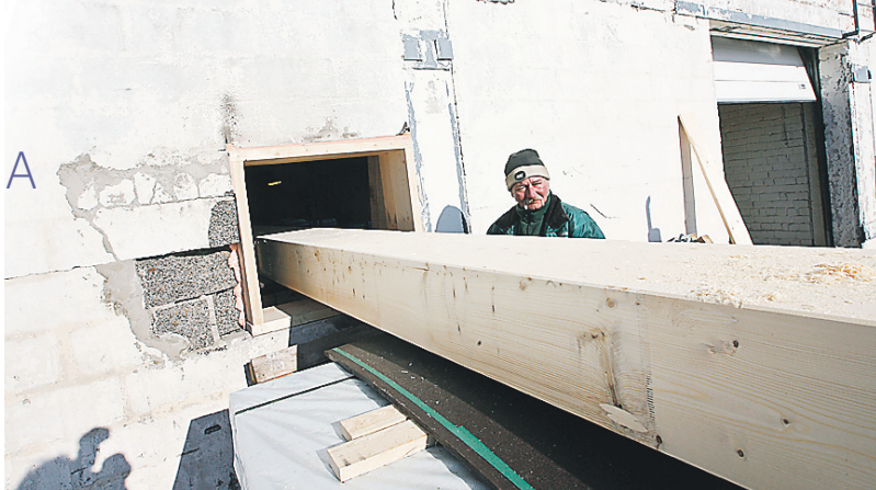
MASSIIVSETE liimpuidust talade tarbeks tuli tootmishoone seina teha spetsiaalne ava, et CNC-pink saaks detaile toota.
