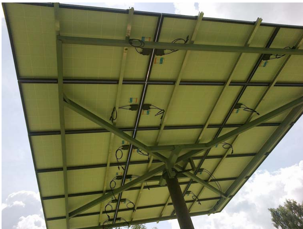
Joonis 2. Päikesepaneelide tugisammas koos hoideraamiga Figure 2. The solar photovoltaics panels groundsel with holding frame
