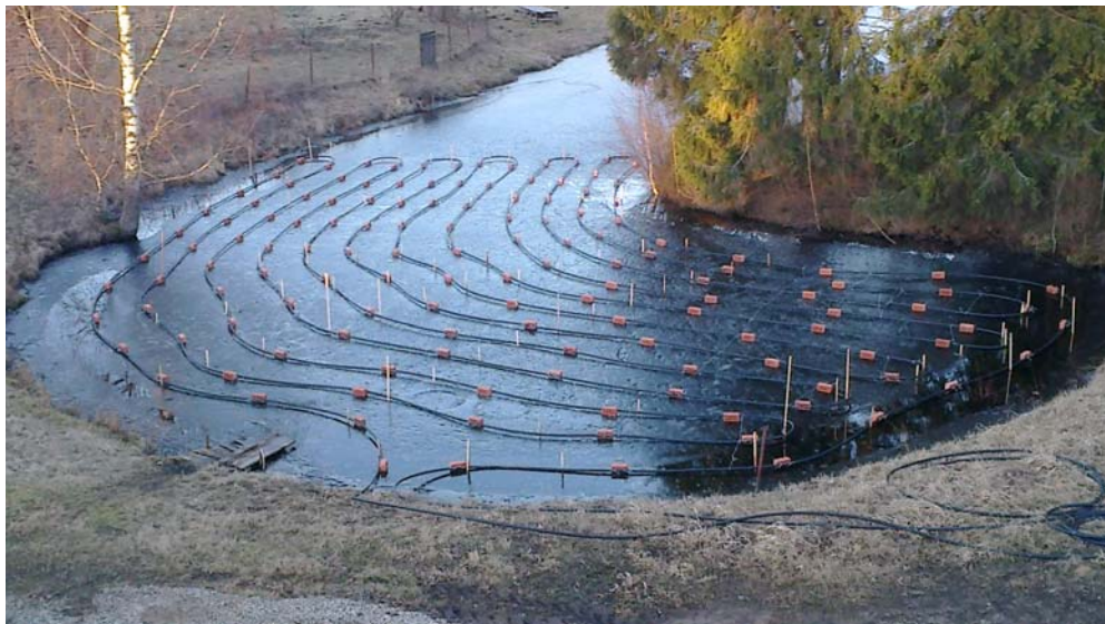
Joonis 6. Soojuspumba energiakogumise torustik koos ankrutega tiigi jääl Figure 6. The heat pump pipes with anchors on the pond ice
