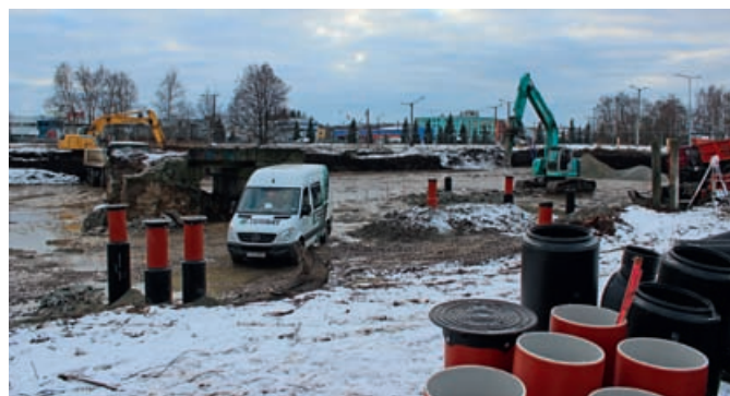
Põhja keskuse töösaal Osmussaare tee 2 majas (illustreeriv pilt) ja ehitus 2013. a detsembris
