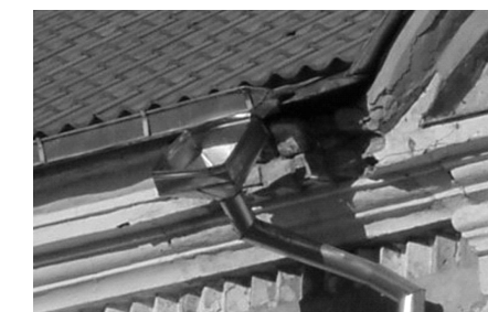
Nõrk konstruktsioon, lisaks puudub katusel lumetõke. Ahja mõis. (Foto: J. Vali)
