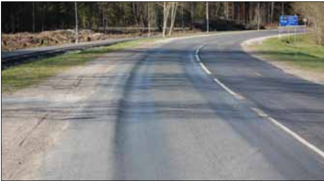
Joonis 5. Riigimaantee nr 12 Kose-Jägala, Kose asulasse sisse sõidul Jägala poolt tules, kevadel 2011. Kattel on näha topeltrastastest põhjustatud jäävdeformatsioonid ühel sõidusuunal (n-õ veosuund). Vasakul pool teed on näha raielank.
