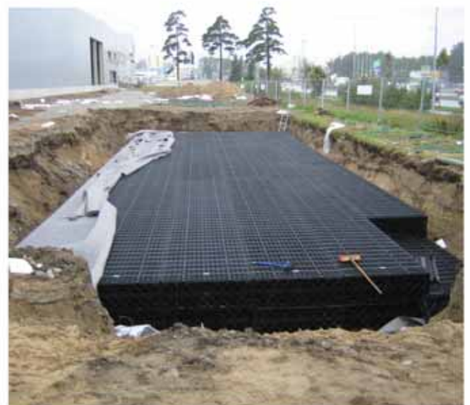
Foto 2. Tammsaare tee äärde ehitatud Tondi Rautakesko kaupluse hoone katuse- ja parkimisplatsivee juhitakse HeitkerBloc -moodulitest koostatud mahutisse
