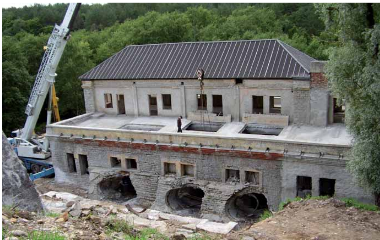
Taastatava Jägala hüdroelektrijaama hoone.
