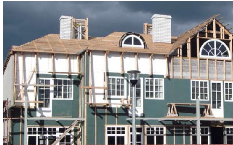
Hoone on osaliselt soojustatud kivivillaga, millel on tuletõkkeks kasutatud tuletõkkeplaati ning maja ülemises osas on soojustuseks vahtplast. Mõlemad on põlevad materjalid ja jäävad konstruktsiooni tuulutuspilusse. Soojustuse ja tuletõkke peale paigaldatakse roovit, millele omakorda puitlaudis. Selline põleva soojustuse ja tuletõkke paigaldus enam kui kahekoruseliste hoonete puhul ei ole alates 2005. aastast projekteeritavate või renoveeritavate hoonete puhul üldjuhul aktsepteeritud.
