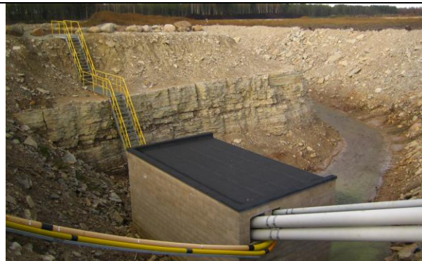
Joonis 90 Ubja põlevkivikarjääri madalaimasse kohta paigutatud pumbajaam
