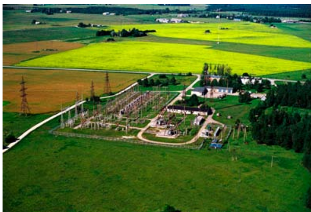
Joonis 80. Aerofoto olemasolevast Aruküla 220/110/10 kV alajaamast.
