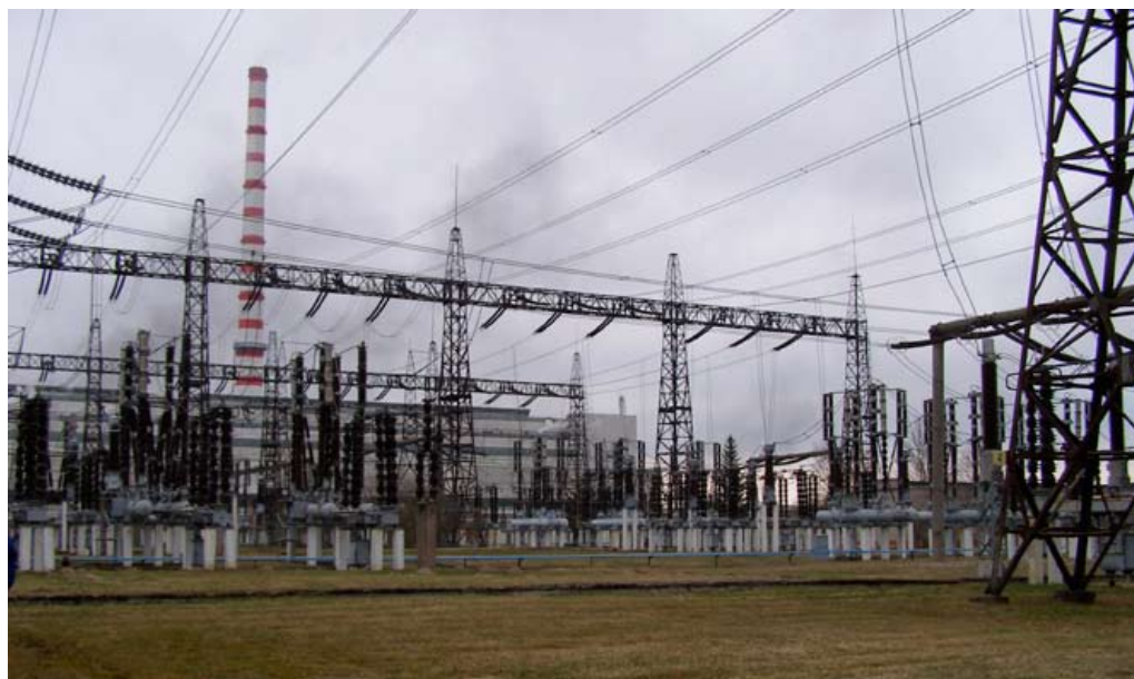
Joonis 83. Eesti elektrijaama 330 kV renoveerimata jaotla aastal 2010
