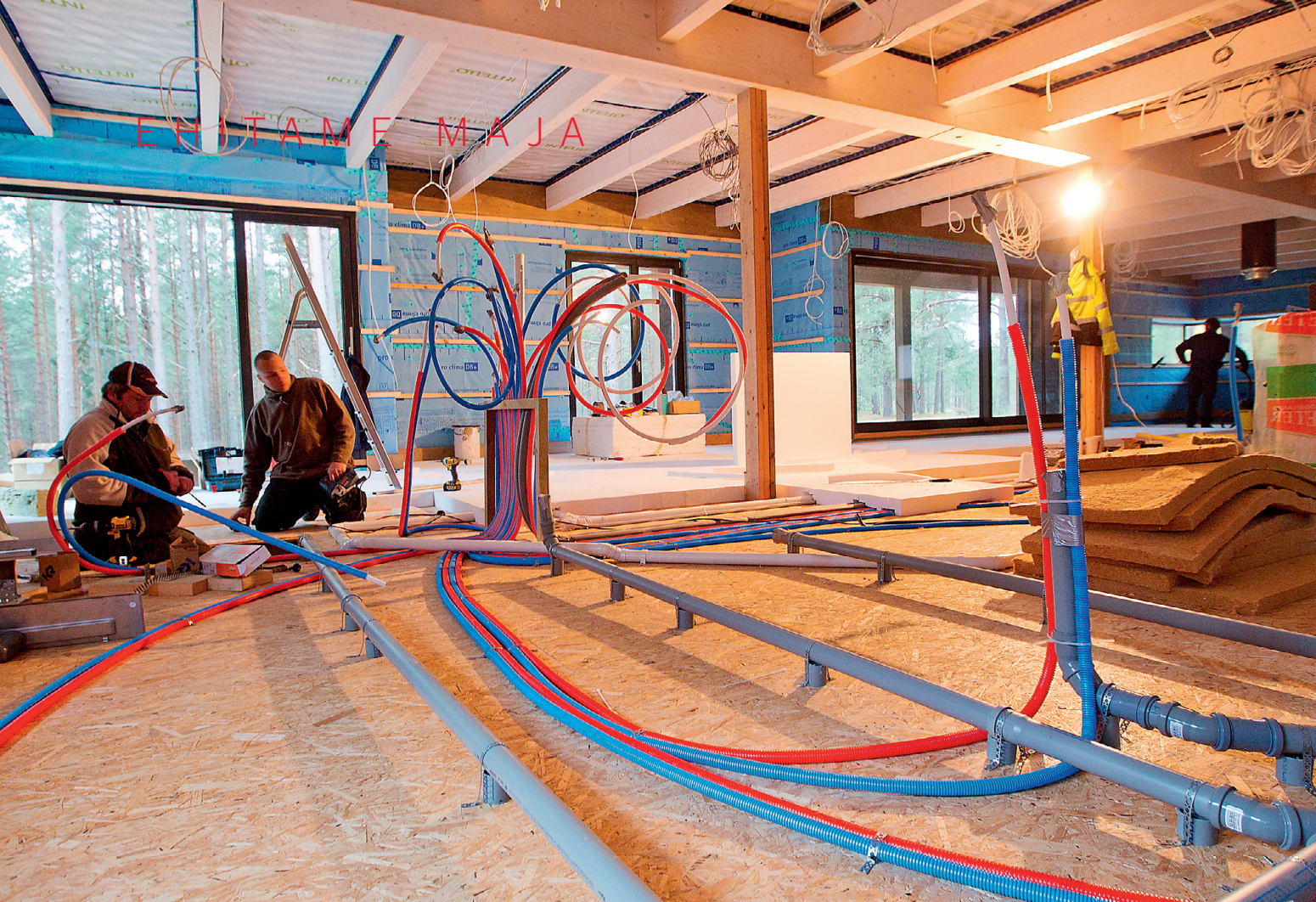
KANALISATSIOONISÜSTEEMI juures tuleb läbi mõelda ligipääsetavus ja vältida liitmikke peidetud kohtades. FOTOD: RAUL MEE
