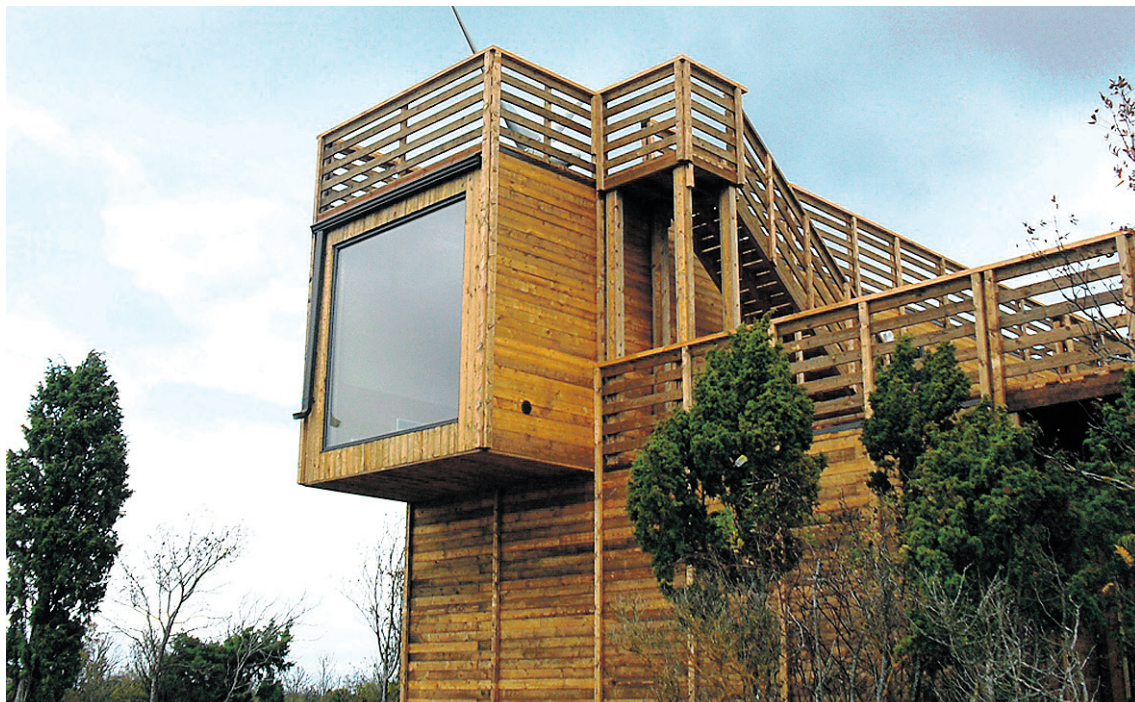
IGA konteinerimaja valmistatakse teraskarkassil ning merekonteineri raami sisse paigaldatakse uued seinad, sise- ja välisviimistlusmaterjalid jms.
