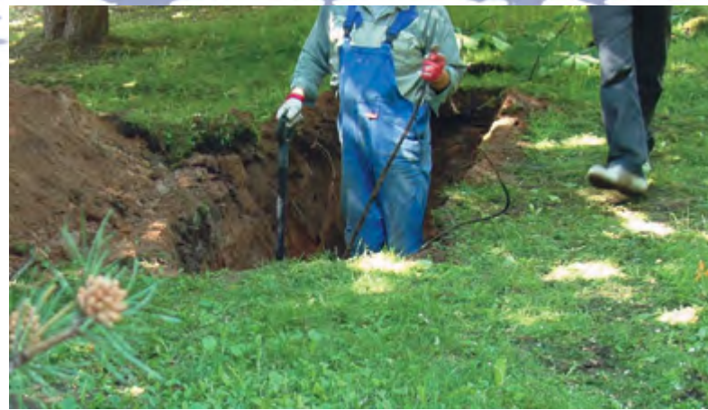
Kaevetööde käigus lõhutud sidekaablid
