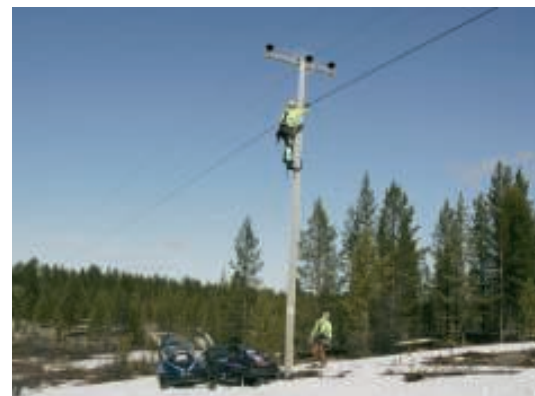
Maasse kaevamise asemel riputatakse lairibaühenduse kaablid pakase tõttu elektripostidele.
