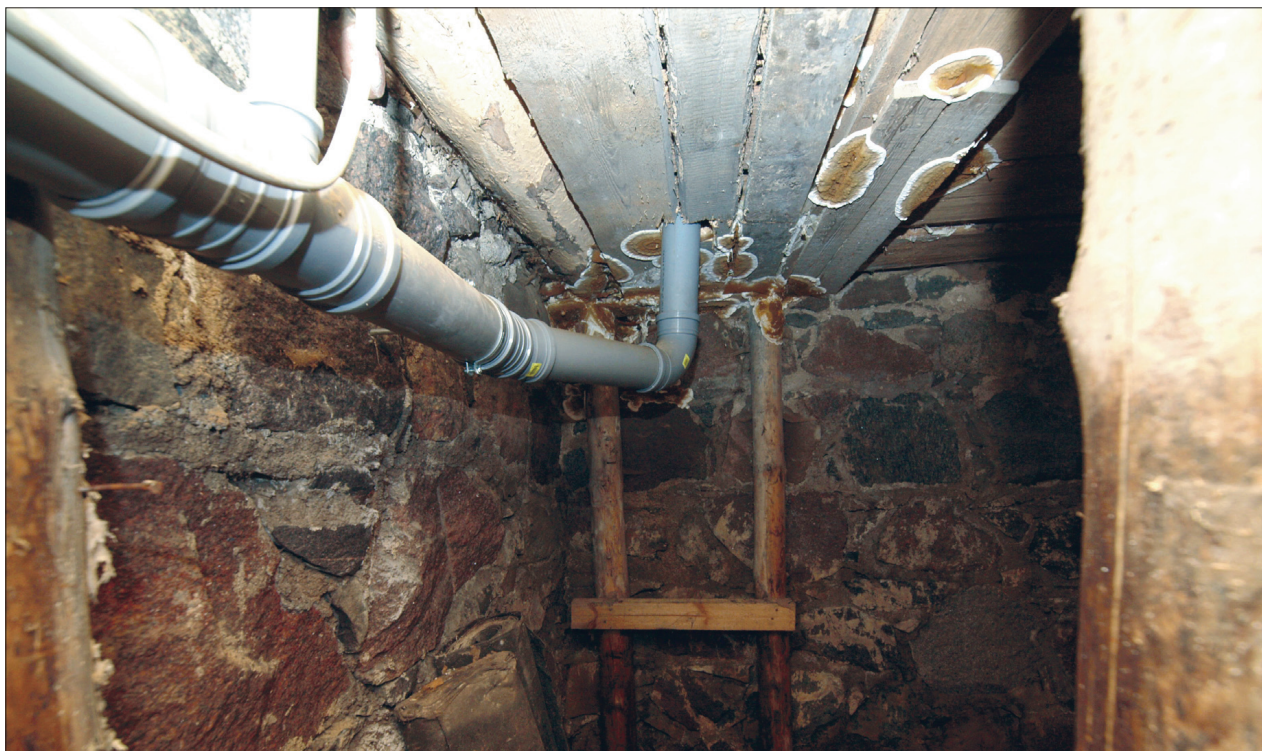
Torustiku lekkest tingitud kahjustus.
