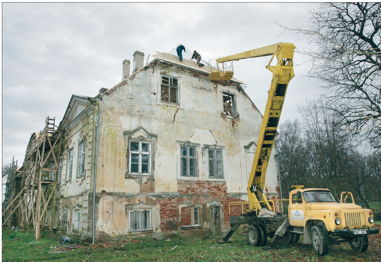
Hoone lammutamisel või renoveerimisel lenduv tolmu ohustab nii töömehi kui ka eemalviibijaid.
