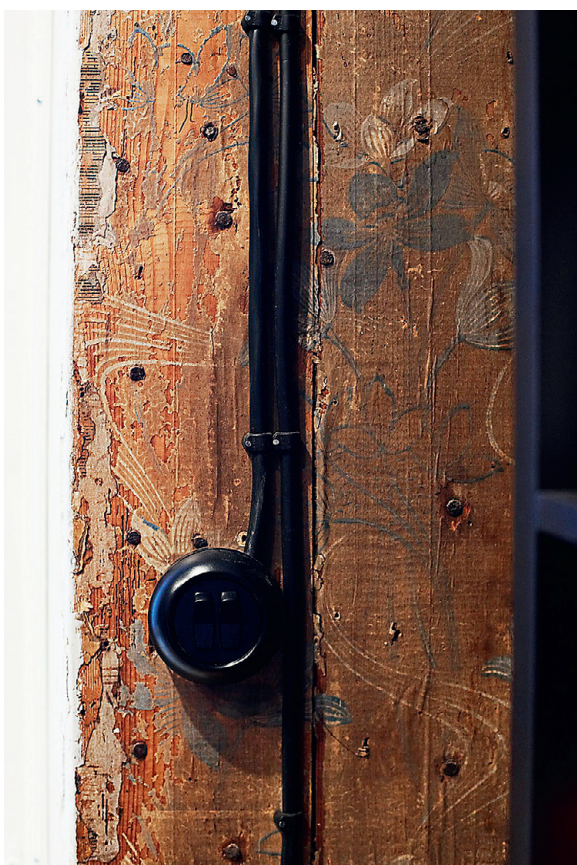
Vana tapeedimustri jäljed puitseinal mõjuvad otsekui maaling. Lähikumav puidusüü ning bordüürijäljed lisavad romantilisust.
