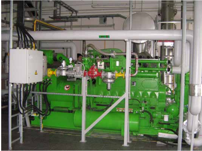
Pilt 2. GE Jenbacheri JMS208 gaasimootor Panevezise veepuhastusjaamas. Picture 2. GE Jenbacher JMS208 gas engine in Panevezis WWTP
