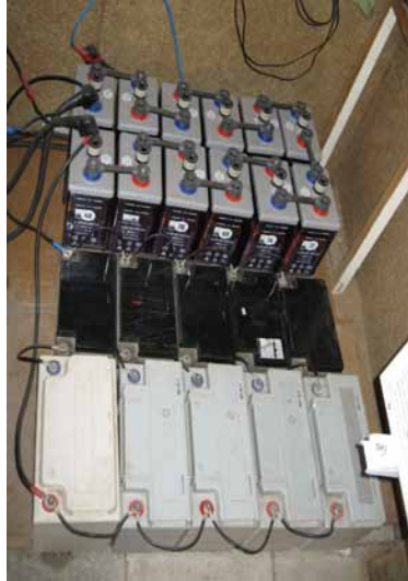
Joonis 5. Akupank Figure 5. Batteries
