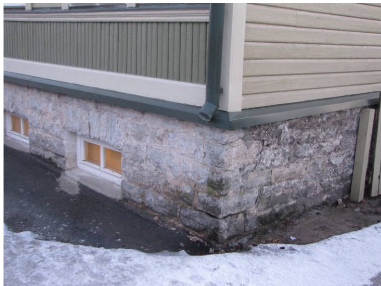
Joonis 3.10 Lumerikkal talvel on soojustamata keldriseinad on sulatanud lume ümber hoone. Vihmaveetoru ei ole viidud maapinnani ja märgab soklit.
