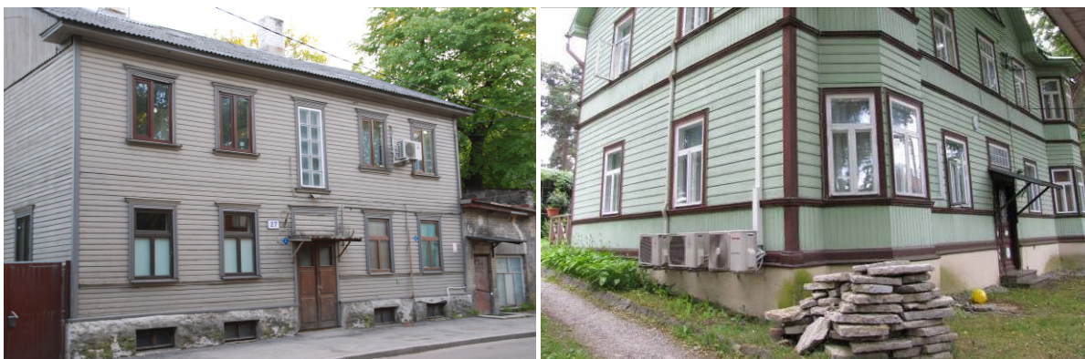
Joonis 13.18 Soojuspumpade välisosi ei ole sobiv paigaldada tänavapoolsetele fassaadidele (vasakul) ja vaadeldavatele külgfassaadidele (paremal).
