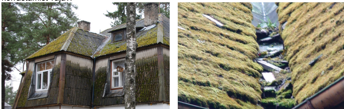
Joonis 2.12 Hooldamata katusel kasvav sammal või muud taimed soodustavad katusekatte lagunemist ja lühendavad oluliselt katuse tööiga.
