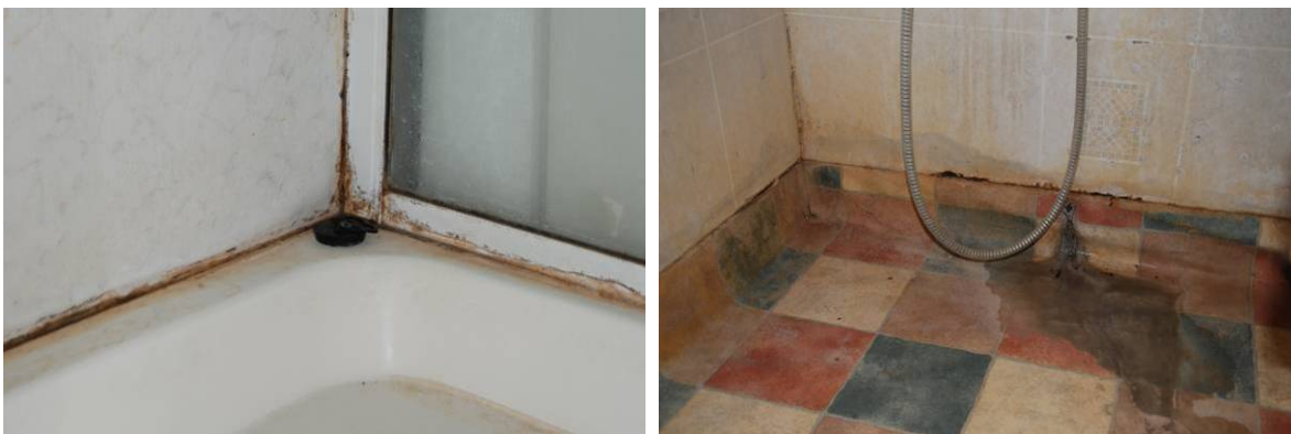
Joonis 2.69 Plastkattega kaetud duširuumides esines sagedalt lekkekohti.
