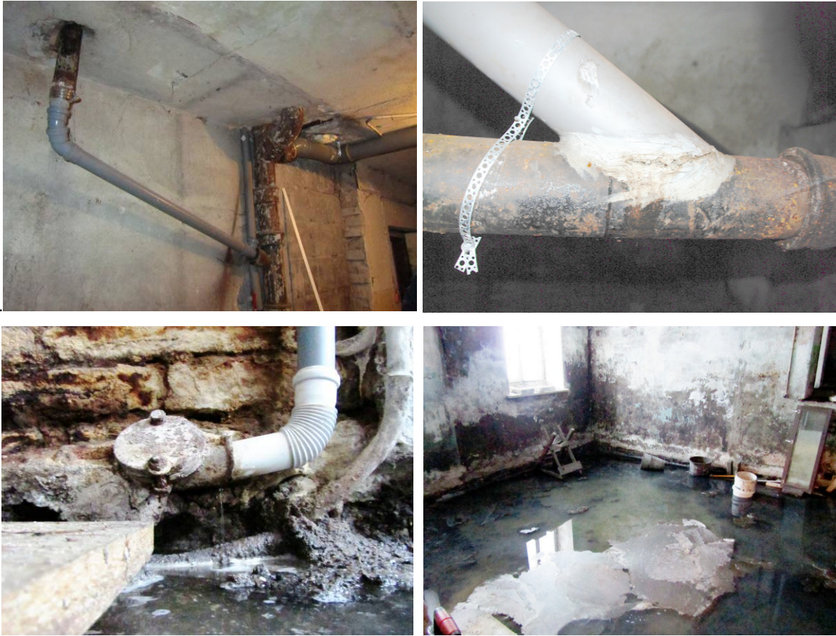
Joonis 10.8 Kanalisatsioonitorude juhuslik ühendamine (üleval ja vasakul), võib viia üleujutuseni keldris (all paremal).
