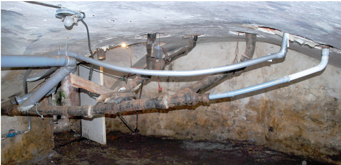
Joonis 10.9 Vale kaldega ja ühendustega vee- ja kanalisatsioonitorustik keldris.
