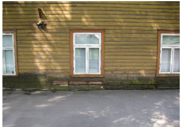
Joonis 2.49 Veelaud on hoonest eemaldunud. Vesi läheb kergelt konstruktsioonide vahele (vasakul). Vee imamine kandeseintesse ei ole takistatud. Ka visuaalselt on märgata, alumised palgid on pehkinud (paremal).
