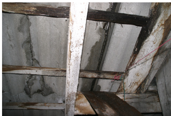
Joonis 2.6 Väljastpoolt vaadates on katusekate korras, kuid eterniitplaatide vahel on praod, kust lekib vesi pööningule.
