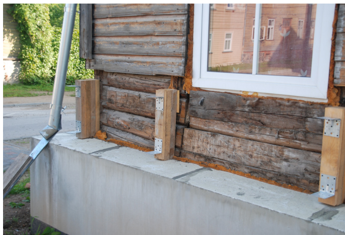
Joonis 3.17 Tehniliselt ja esteetiliselt sobimatult laiaks ehitatud sokkel.
