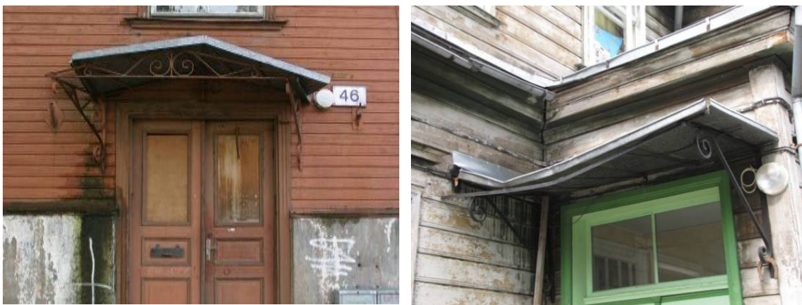
Joonis 2.20 Amortiseerunud varikatuse kandekonstruktsioon ja katteplekk.
