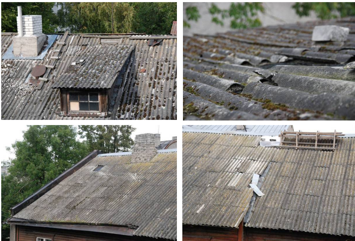
Joonis 2.5 Lagunenud eterniitkatvus, puuduvad harjalauad, liited vintskapiga: katuse tööga on lõppenud ja tuleb välja vahetada.
