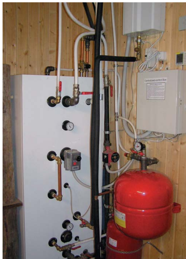
Akumulaatori paagiga on ühendatud õhk-vesi-soojuspump, päikesepaneelid ja 6 kW-ne elektritenn
