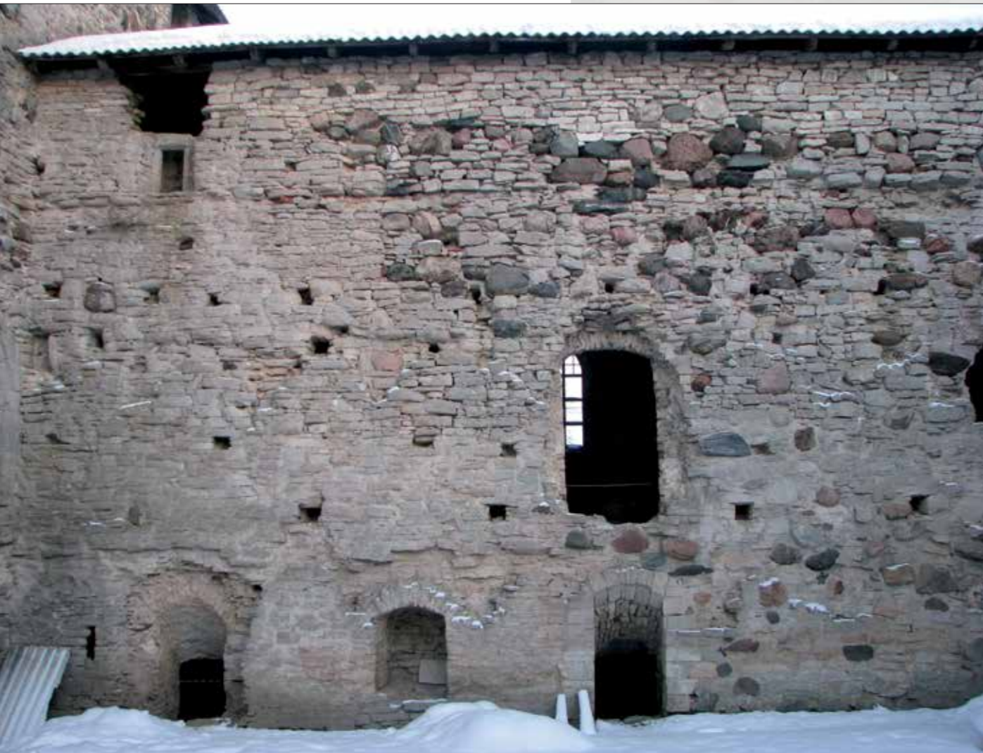
Kuva 29. Luostarin itäsiiven pihanpuoleinen julkisivu. Vasemmalta ylhäältä, sakariston ikkunan kohdalta kulkee rosoinen pystysauma oikealle alas kapitulisalin ja sen alapuolella olevan kellarin oviaukkoon asti (kuva: Villu Kadakas).
