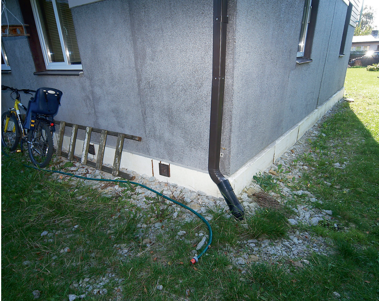
TALLINNAS Pirita linnaosas asuv maja, mis läbis majavammi tõttu 2010. aastal kapitaalremondi. Millise kahjustusega täpsemalt tegu, näitasid hoone ventilatsioonivadest võetud proovid. FOTO: ERAKOOGU
