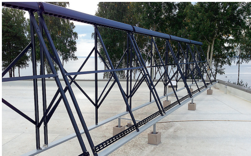
KAKUMÄEL katusele paigaldatud viie päikesekütteepaneeli raamid, kokku 12,5 m, süsteem kütab tarbevett, akupaaki ja suvehooajal välibasseini.
