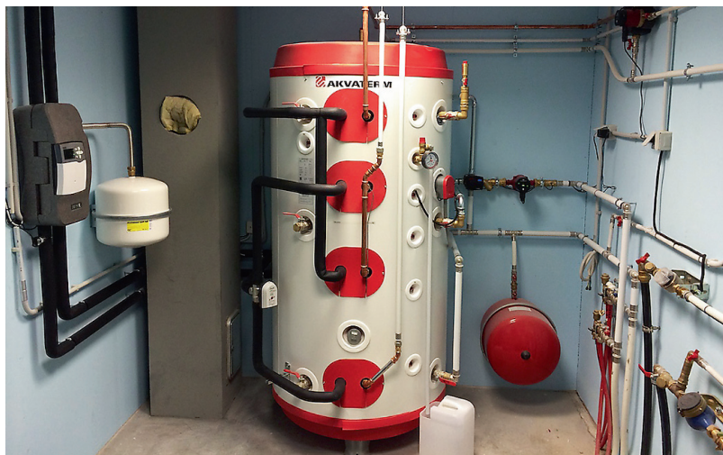
KATLARUUMI seadme ja paneelide vahel jooksevad kaks u 5 cm laiust toru.
