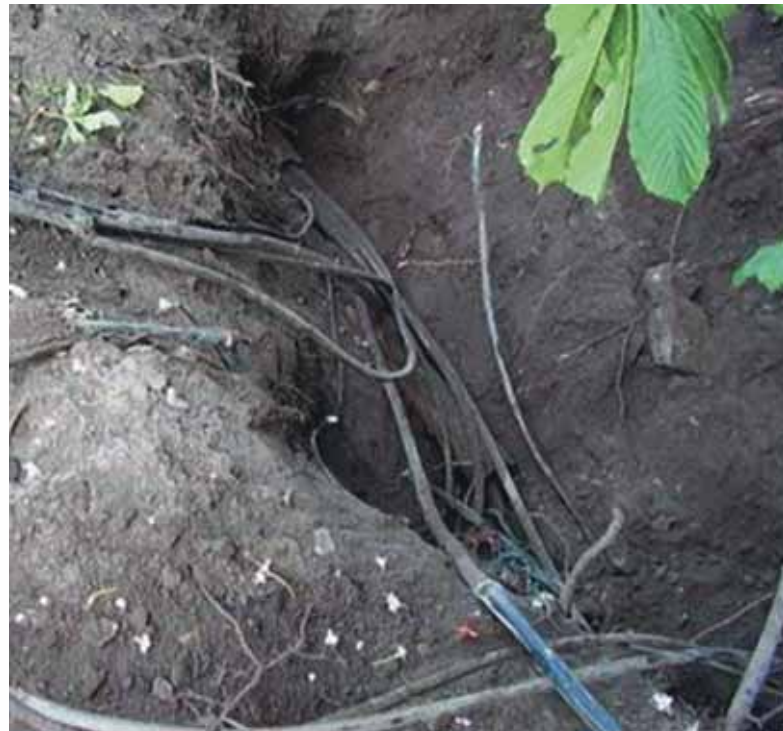
Kaevetööde käigus lõhutud sidekaablid
