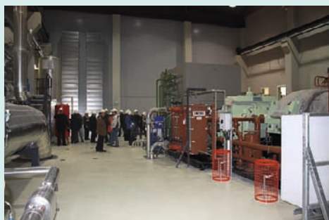
Generaatorisaal. Generators room
