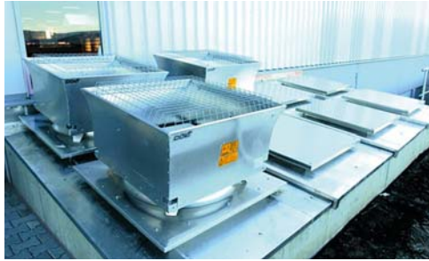
Joonis 57. Suitsu eemaldamise ventilaatorid (Eurovent Est 2014)
