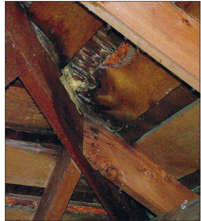
Katuseleke on katusekonstruktsiooni tugevasti kahjustanud.
